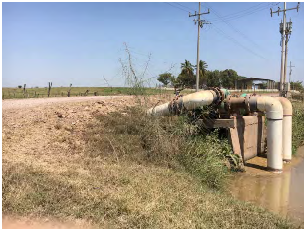
A 10. Bombeo de aguas de canal a UPO
